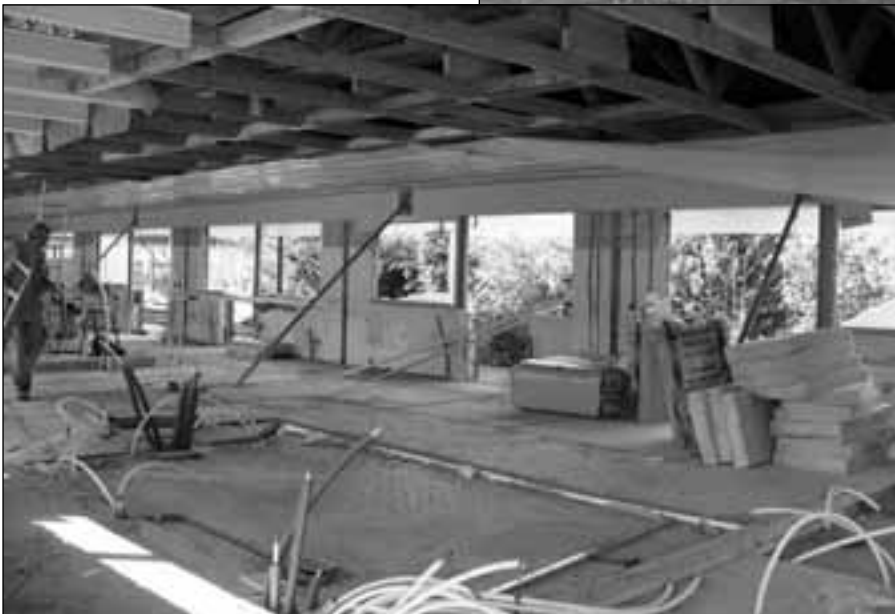
På Asabo er her en af de gamle fløje under renovering. Alt indmad er pillet ud for at skabe de nye rammer.
